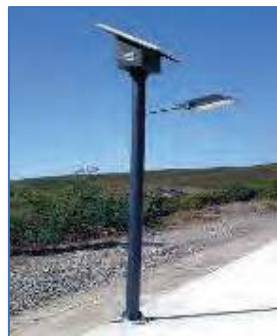
Figure 77 : Eclairage à l'énergie solaire
