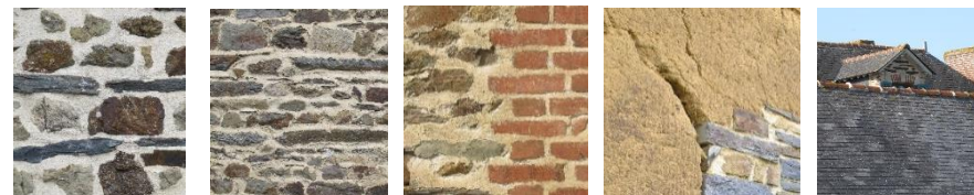
Moellons de schiste et de grès, maçonnerie de briques, bauge et couverture d'ardoises
